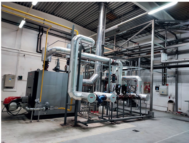
We wschodniej nawie hali znajdują się pomieszczenia techniczne, w tym m.in. zbiorników wodnych, kotłowni gazowej, rozdzielni średniego i niskiego napięcia. Wzdłuż zespołu pomieszczeń technicznych, a halą znajduje się dwupoziomowy pasaż komunikacyjny, który kontynuuje swój przebieg od strony południowej przylegając do części administracyjno-biurowej.
